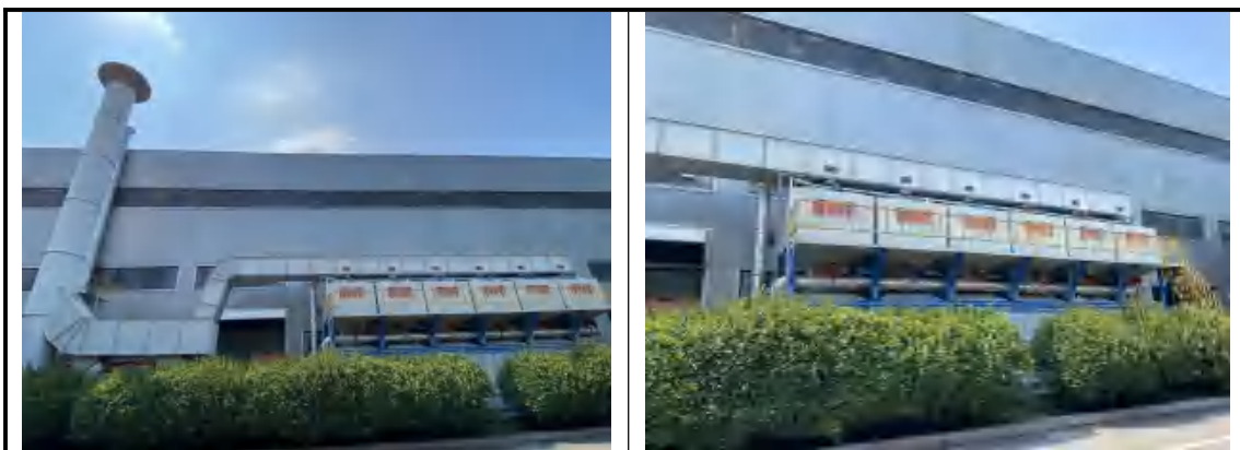
水帘+过滤棉+活性炭+催化燃烧+排气筒 P6
