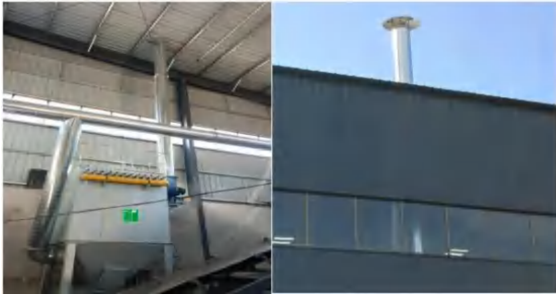
袋式除尘器+DA002 排气筒
